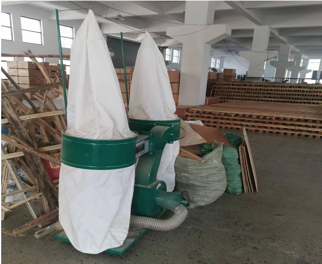
木工车间及布袋除尘器
