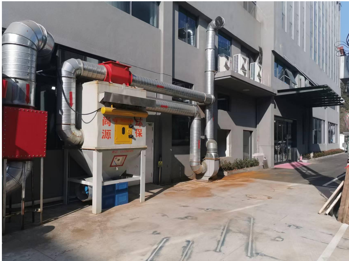
喷塑废气处理设施（布袋除尘器）
