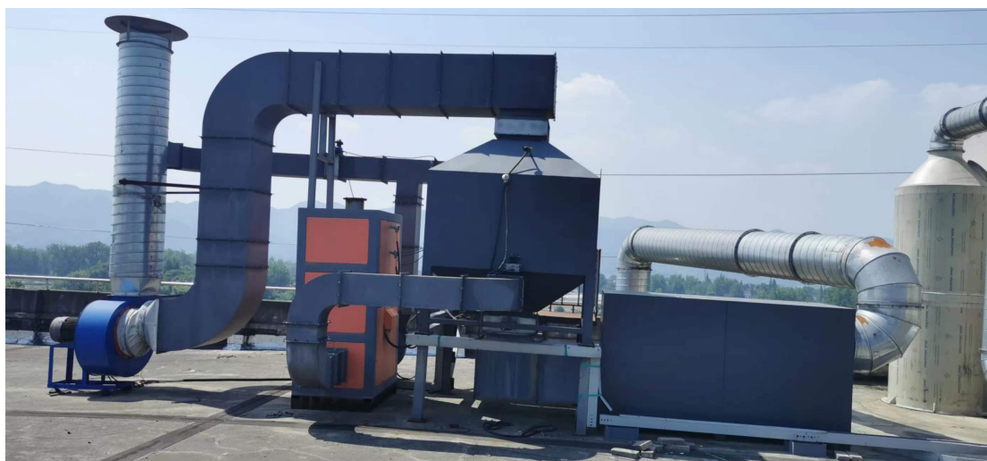
油漆废气处理设备
