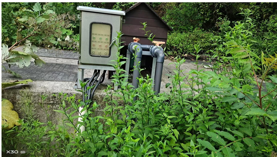
图 3-1 项目废水处理设施
