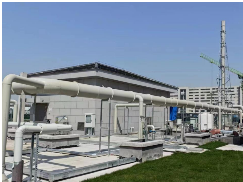
图 4-3 项目污水处理站
