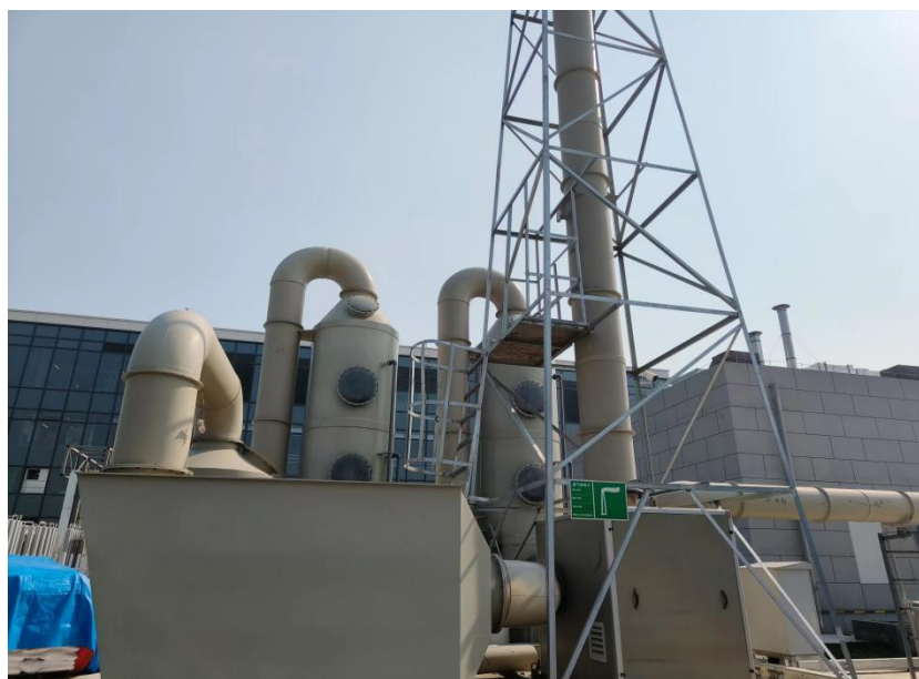
图 4-6 污水处理站废气处理装置
