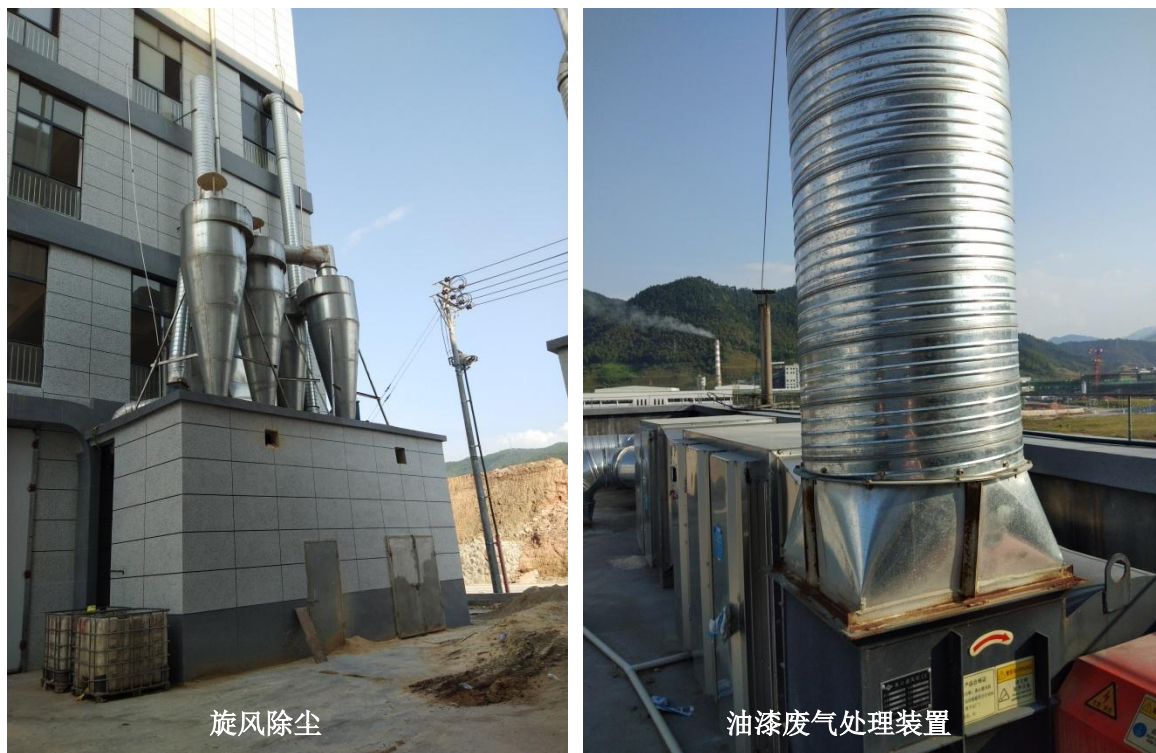
图 3.1-1 项目废气污染防治设施现场照片
