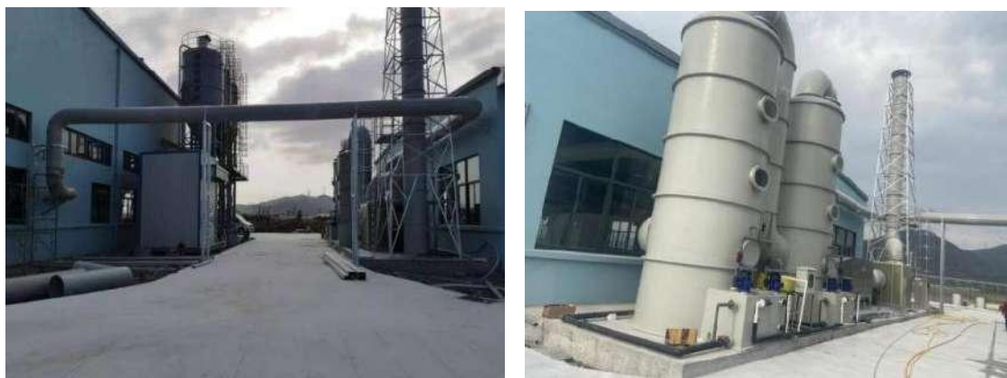
固化车间、暂存库废气处理系统
