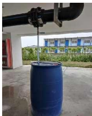
填埋区渗滤液收集桶
