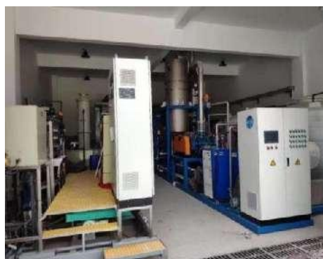
污水处理设施
